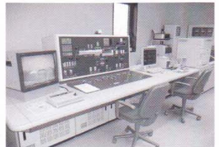
「制御システム」
